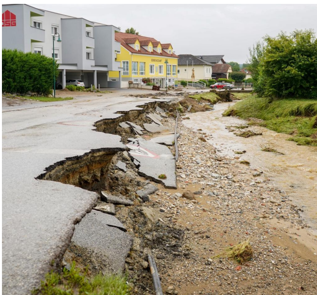
Schäden durch die Überschwemmungen.
